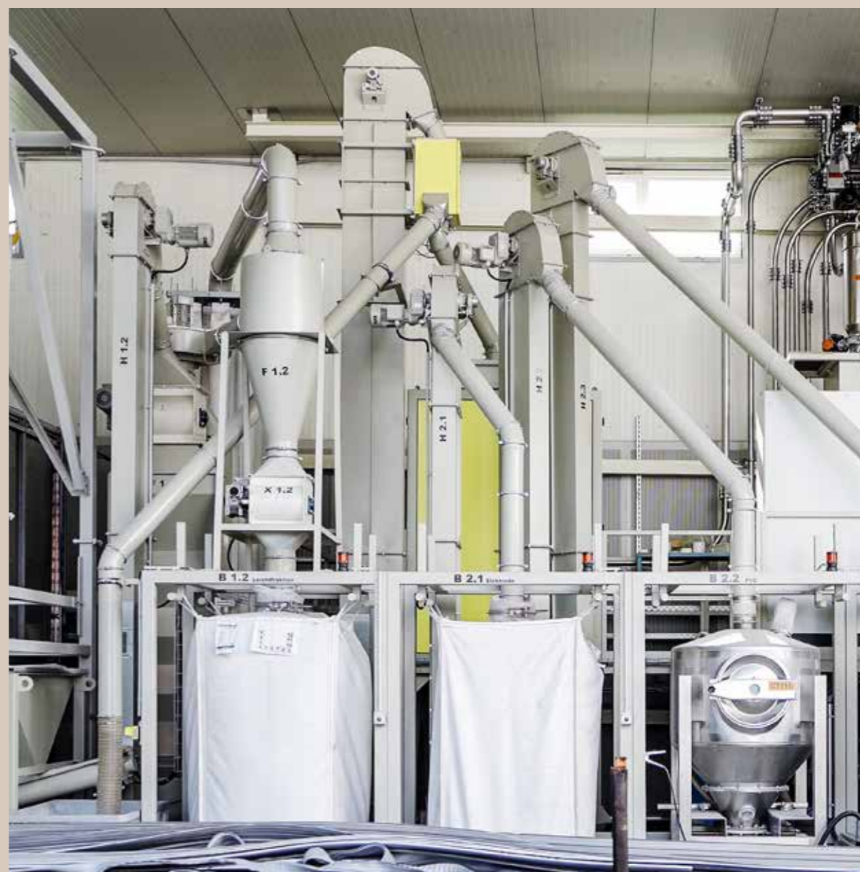
Il moderno impianto di riciclaggio consente di riutilizzare internamente tutti gli scarti e ritagli dei profili in PVC di propria produzione.
